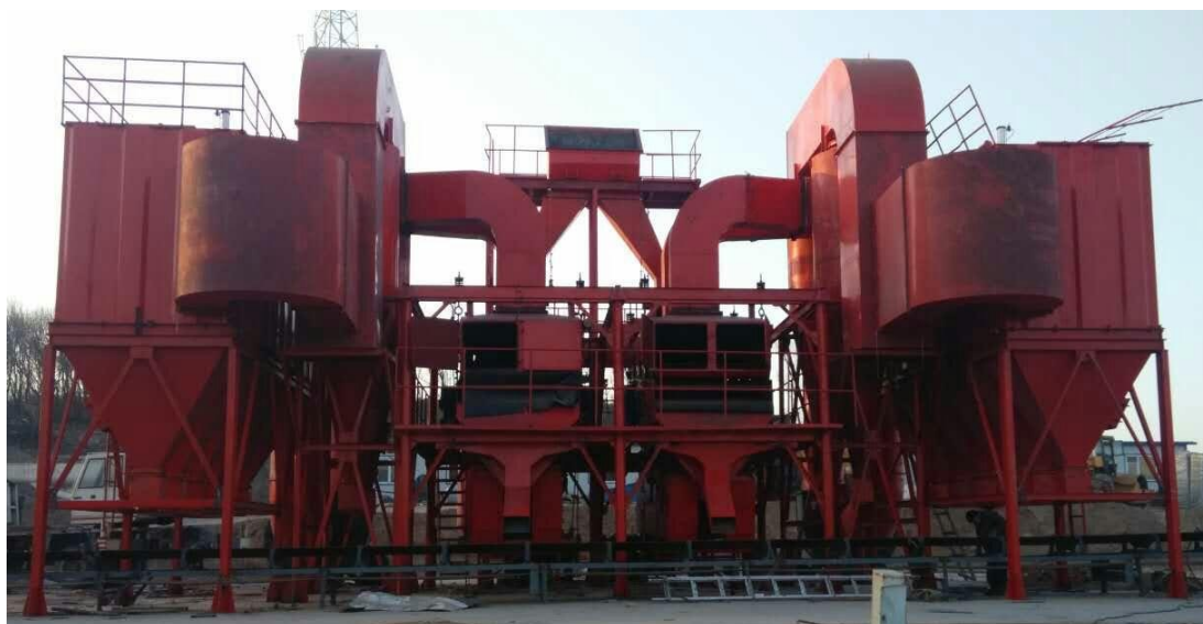
图 2-22 已建项目设备照片
