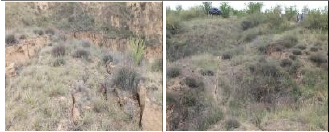
图 5.2-6 地裂缝现状照片
